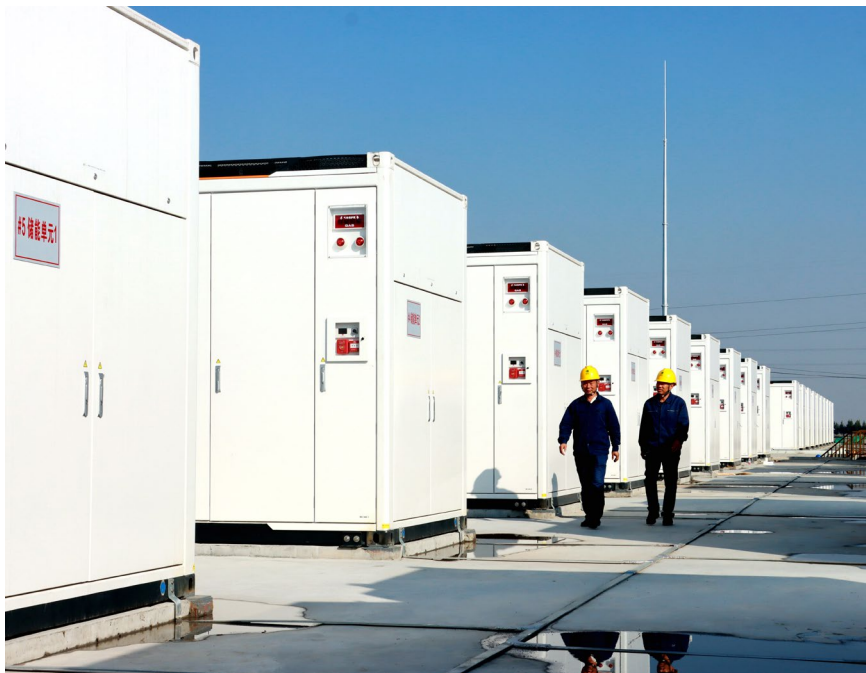
共产党员服务队在新建储能电站服务/成博浩 摄
